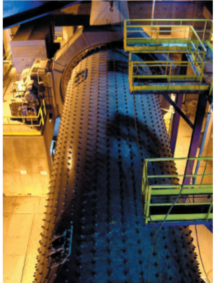
Abb.9: Rohrmühle mit DMG2
