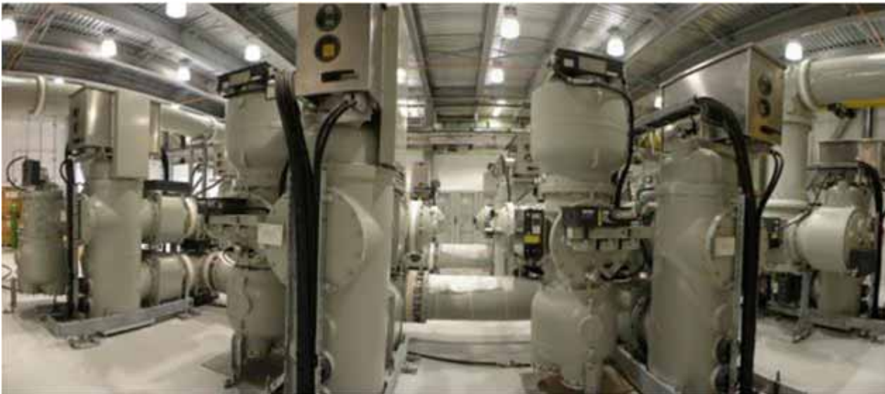
USA – Port Arthur – 69 kV
