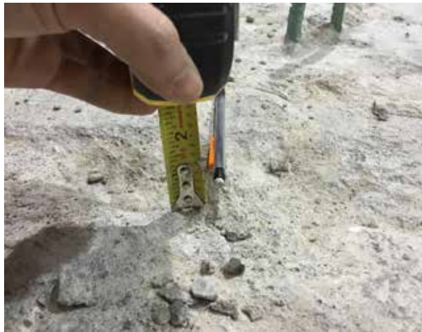
(d) Crater in Girder Top Flange (Girder #1)
